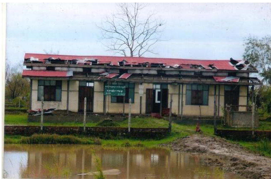
サイクロン直後の学校 右端の貯水槽の屋根は吹き飛ばされてます 現在貯水槽の屋根は修復済み
