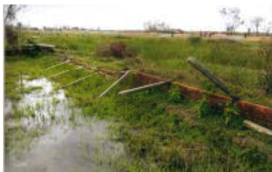
←倒れた柵と土台のレンガ 現在も復旧されてません
